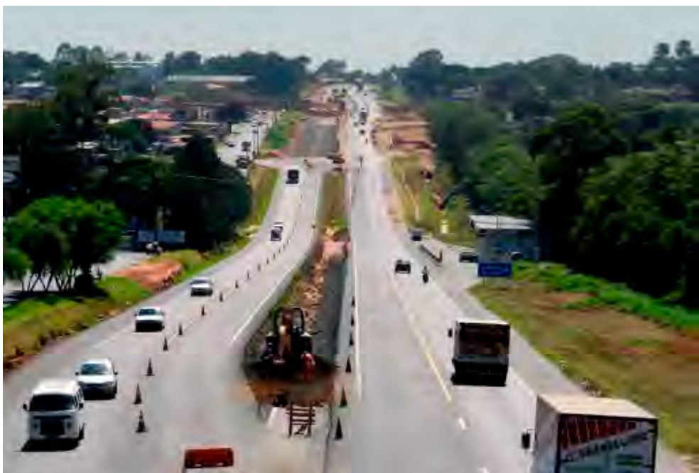
Fotografia 5 - Obra de alargamento da SP-101, fevereiro de 2013. Fonte: Site Rodovias do Tietê.
