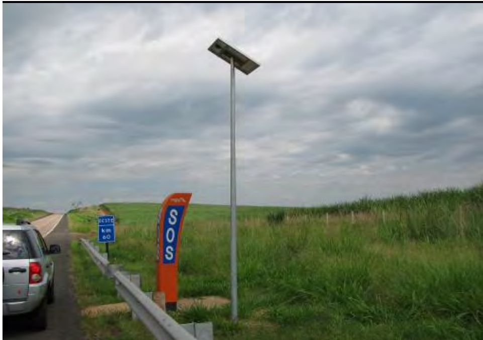
Foto 31. Telefone de emergência instalado em toda extensão da concessão, a cada quilômetro.
