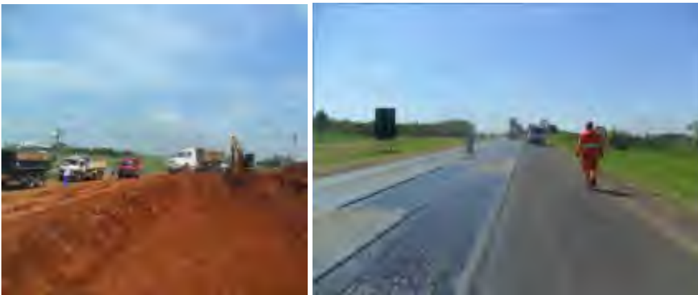
Fotografia 3 – Esquerda: Terraplanagem em na duplicação da SP-308. Direita: Andamento da pavimentação da duplicação da SP-308. Fonte: Relatório de andamento, dezembro de 2012
